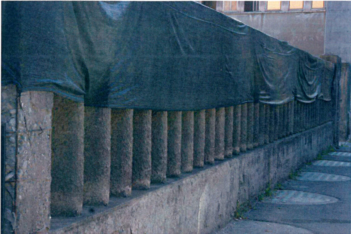
Vista della recinzione in calcestruzzo armato e acciaio presente su via G. Elter
