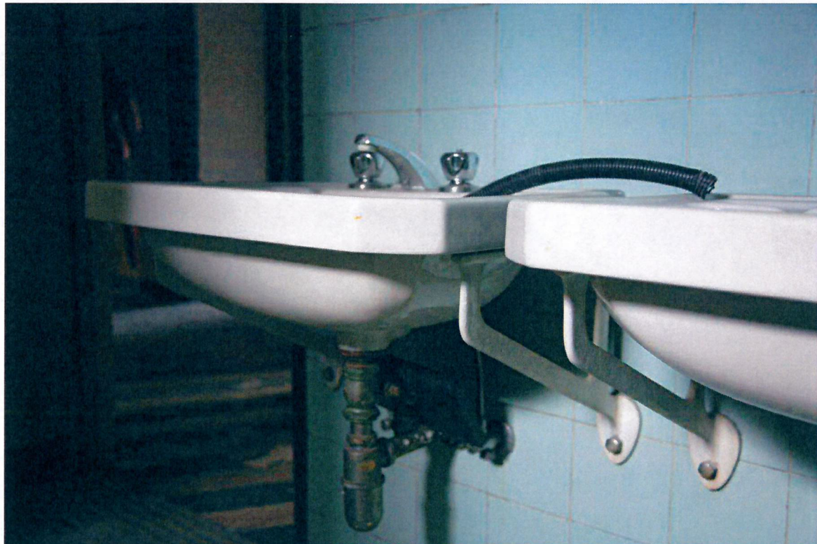
Particolare dei sanitari dei servizi igienici del terzo piano.
