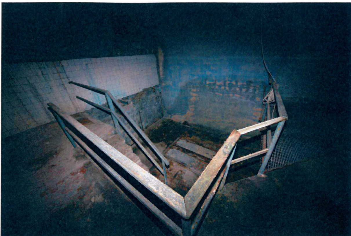
Vista locale caldaia primo piano interrato.
