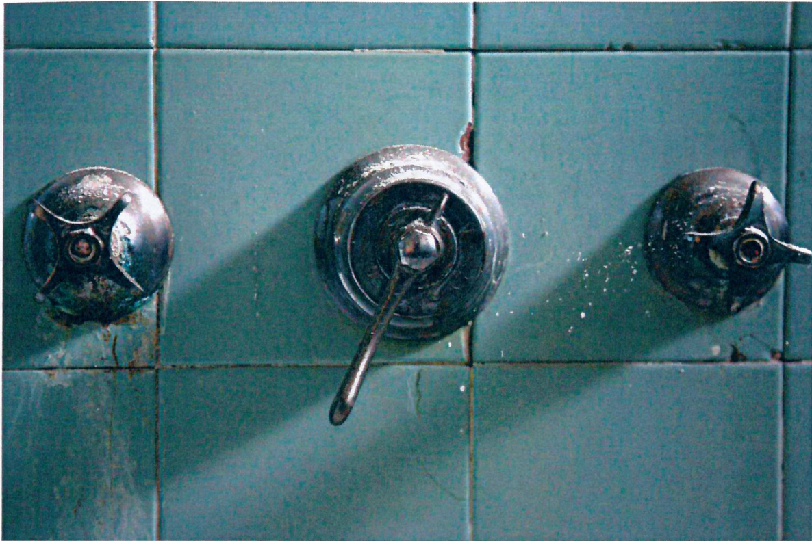
Particolare della rubinetteria dei servizi igienici del terzo piano.
