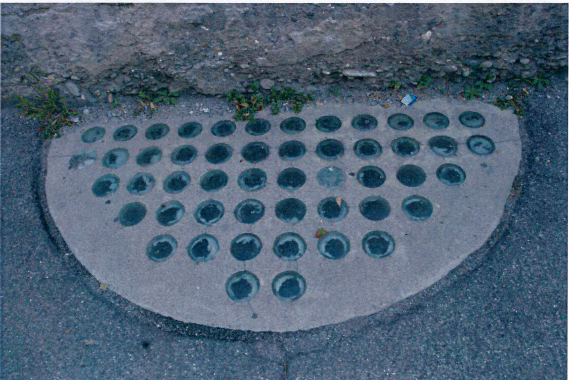
Particolare del pavimento con inserti in vetro-cemento che illumina il primo piano interrato.
