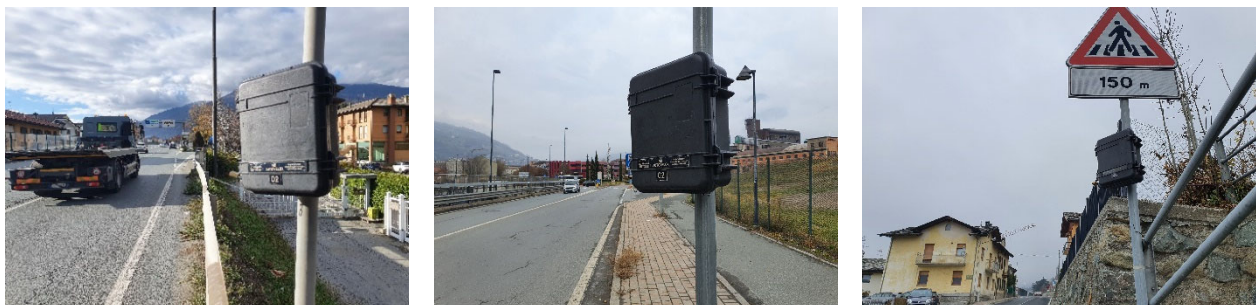
Montaggio delle apparecchiature Radar ad Aosta (Sezioni da sinistra a destra S04, S11 e S03)
